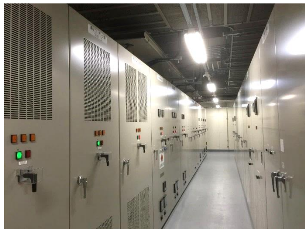
電源: 自家発電作動 72時間 フルパワー 10日間 セーフティモード
