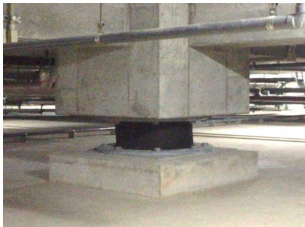
診療棟・病棟地下の 免震設備(72基)
